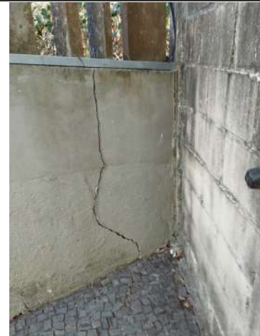
Imagem 08: Destaque para uma considerável trinca no muro frontal, indicando que o muro da lateral esquerda, margem do F Pequeno, está cedendo.
