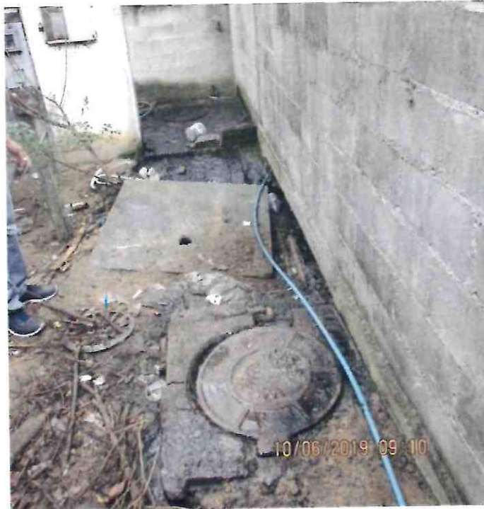
Elevatória Bairro Aviso
