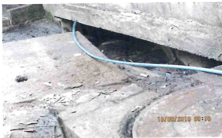
Elevatória Bairro Aviso
