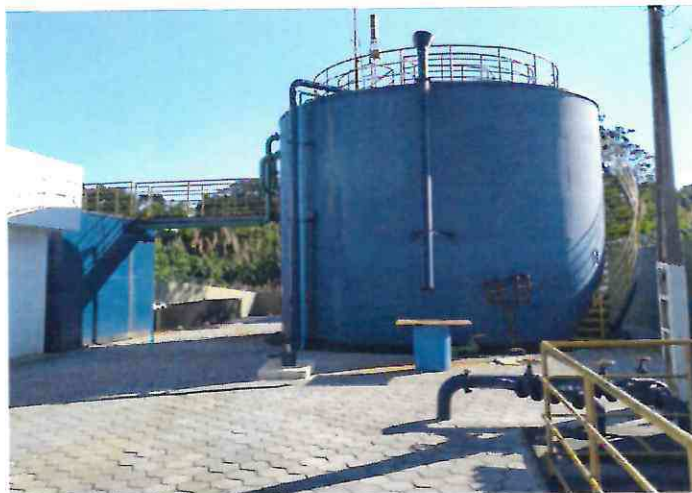
ETE Bairro Bebedouro
