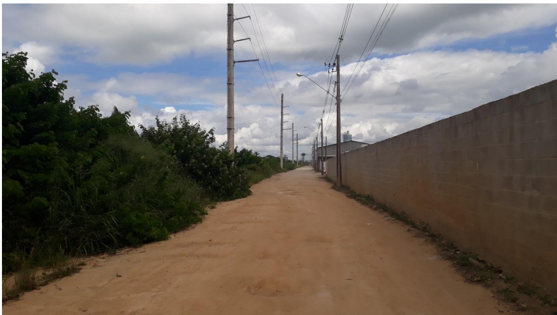
Imagem 25 - Trecho da Rua Nivaldo Alberto Salles, sentido Rodovia BR 101, não possui pavimentação ou sinalização.
