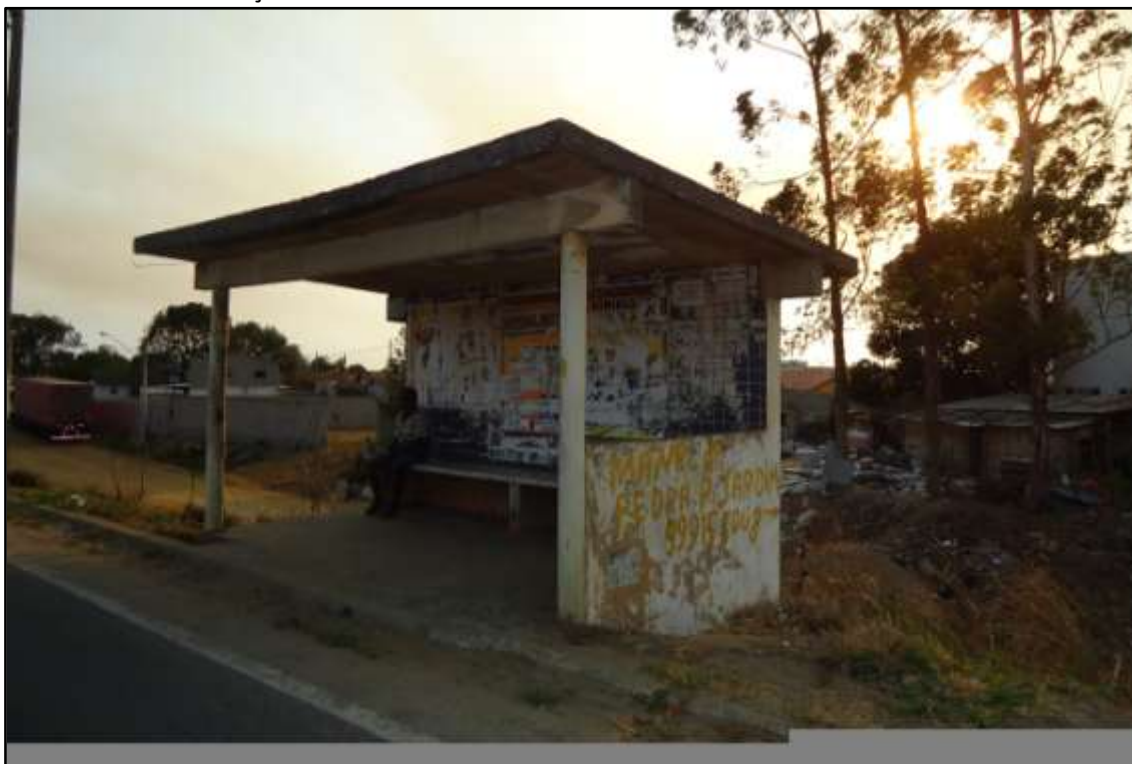
Imagem 23 - Ponto de ônibus 03 – em Bebedouro, fora do padrão da Prefeitura Municipal de Linhares e sem condições de acessibilidade a PNE.
