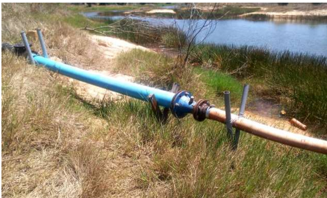
Imagem 50 – Tubulação para abastecimento da água.
