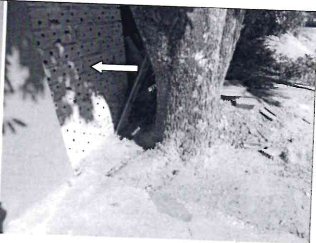
Figura 2 – Destaque para o padrão de energia que está sendo construído no próprio muro, árvore muito próxima e a mesma trará dificuldades à ESCELSA na ligação e problemas futuros à fiação.
