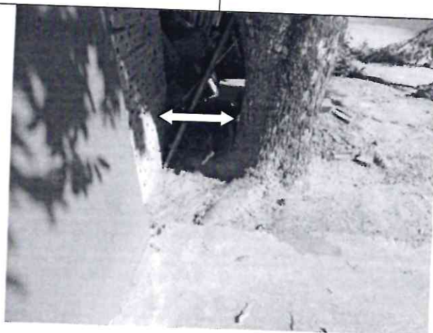
Figura 3 – Árvore muito próxima ao muro e padrão de energia que está sendo construído.
